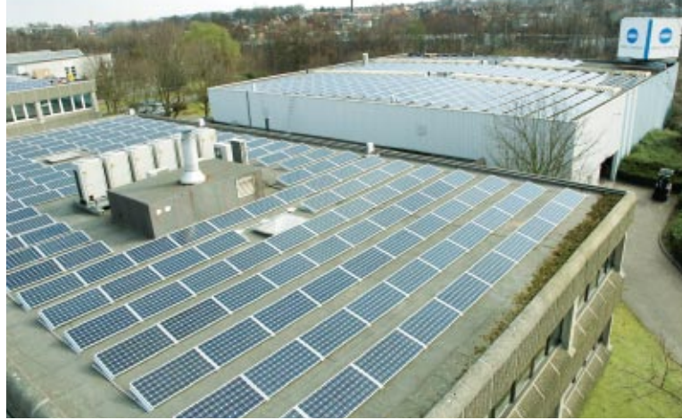
社屋の屋根全面に設置した太陽光発電設備
